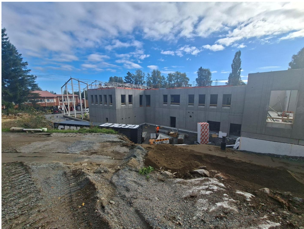
Kuva 1. Sisäpihan ulkoseinää ja etualalla näkyy Geolon maalämpökontti, jolla lämmitetään ja viilennetään rakennusaikana.
