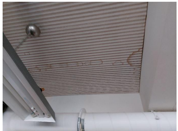
Kuva 36. Kosteusjälkiä veistosalin katon akustiikkalevyissä.
