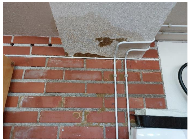
Kuva 38. Vauriot ovat arviolta aiheutuneet yläpuolisen wc-tilan viemäriveruodosta.
