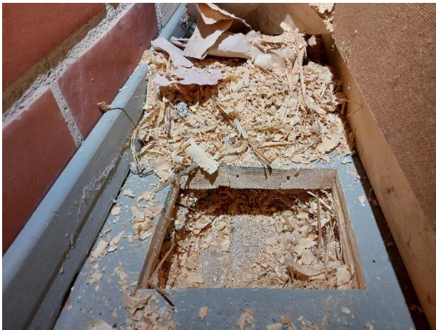
Kuva 15. Veistosalin lattiassa on rakennusjätteestä koostuva täyttökerros, jossa on arviolta paikoin mikrobikasvustoa.
