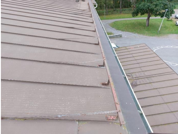
Kuva 46. Vanha katteen läpi kiinnitetty lumieste pääsisäänkäyntiaulan yläpuolella.
