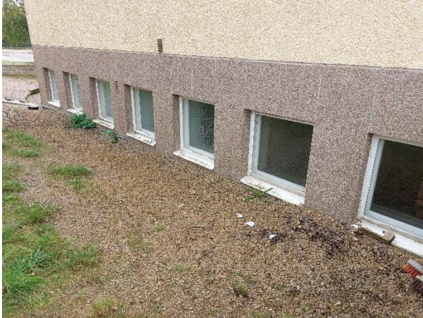
Kuva 10. Kellarikerroksen ikkunat ovat paikoin maan pinnan tasolla. Tämä mahdollistaa sulamisvesien valumisen rakenteisiin.
