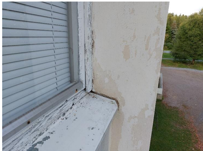
Kuva 29. Ikkunoiden vesipellitusten reunanostoja ei ole tiivistetty ulkoseinää vasten.
