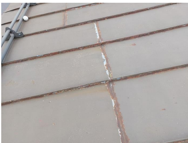
Kuva 44. Katteen saumoissa ruostevaurioita.
