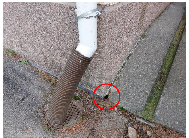
Kuva 9. Asfaltoidulla etupihalla rakennuksen vierusta ei ole riittävän tiivis.
