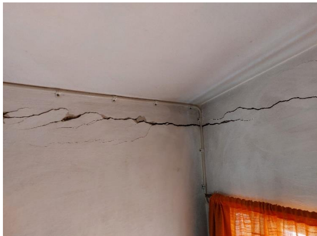
Kuva 28. Liikuntasalin ulkoseinän yläosassa vaakasuuntainen halkeama.
