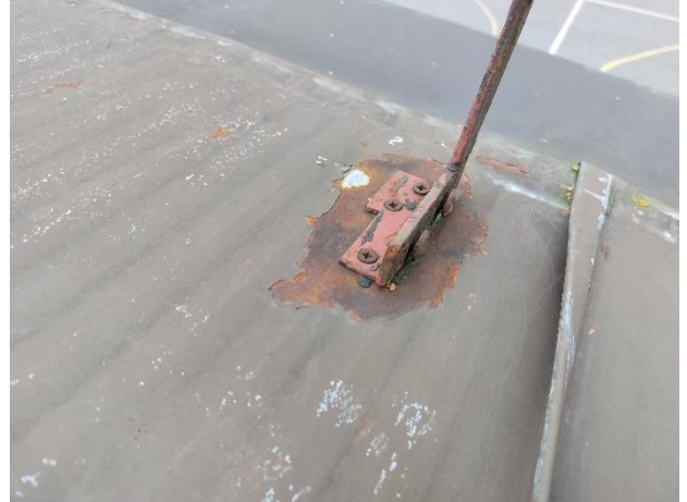
Kuva 47. Vanhan lumiesteen jalkojen kiinnityspisteet vuotavat.
