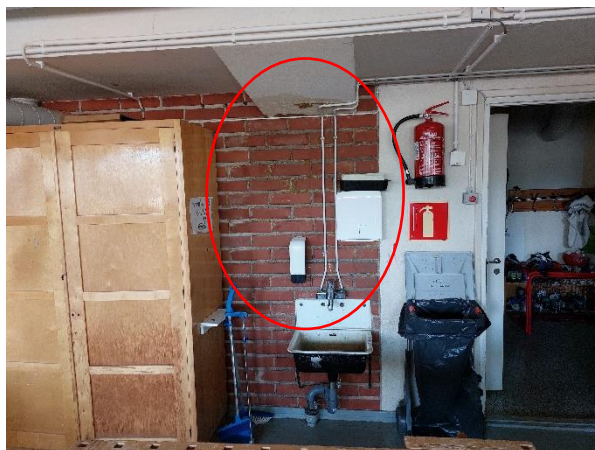
Kuva 37. Veistosalin katossa ja väliseinässä havaittiin kosteus- ja mikrobivaurio.
