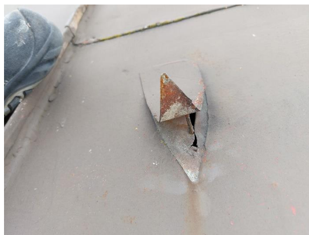
Kuva 45. Katteessa oleva paikka revennyt auki.
