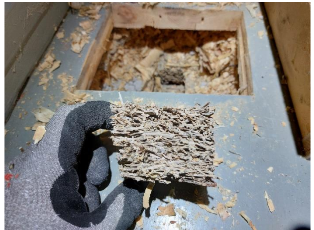
Kuva 16. Veistosalin lattian puukuitusementtilevyssä on viite mikrobivauriosta.
