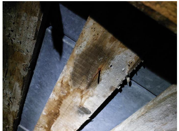
Kuva 49. Vesikaton ruodelaudoissa kosteusjälkiä.
