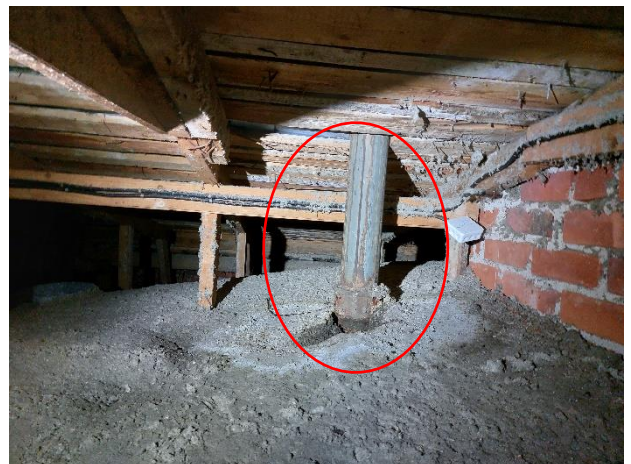
Kuva 51. Aktiivinen vuoto luokkatilojen yläpuolella olevassa viemärin tuuletusputkessa.
