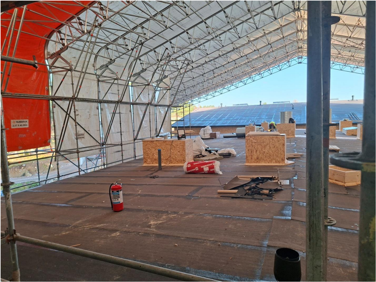
Kuva 2. Alempi vesikatto kohta pohjahuovassa.
